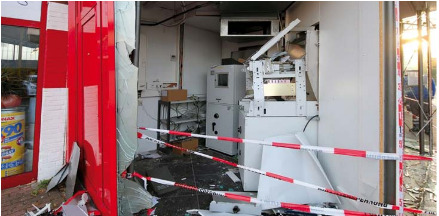
Durch den Einsatz von Sprengstoff verursachen die Täter regelmäßig einen beträchtlichen Sachschaden.
